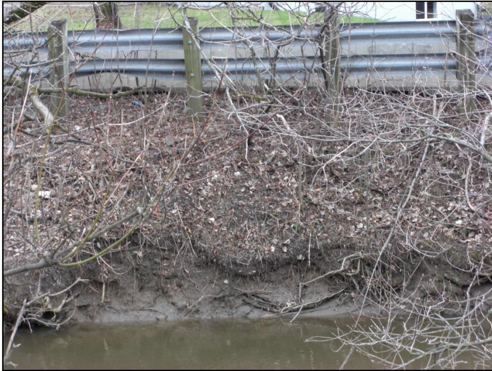
Photo 1 Rive droite en érosion, PK 0+540 avril 2017).
