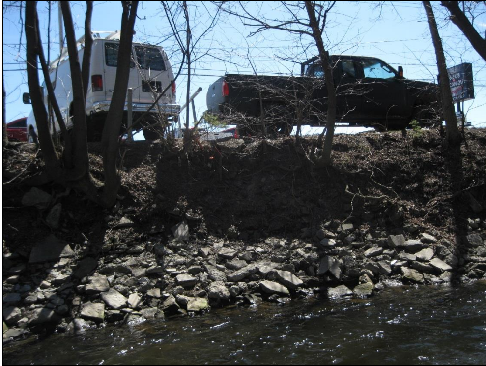
Photo 5 Rive droite en érosion, PK 3+590 (avril 2016).
