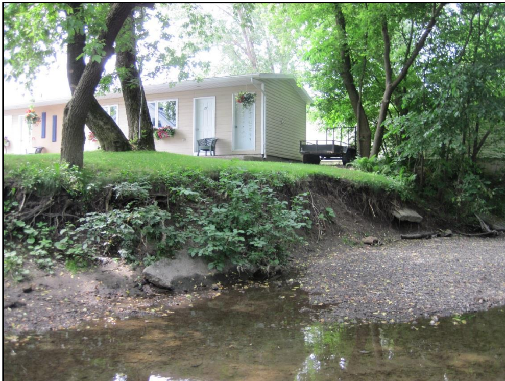
Photo 4 Rive droite en érosion, PK 3+420 (juillet 2012).
