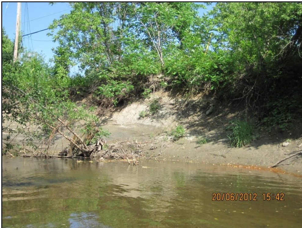
Photo 2 Rive droite en érosion, PK 1+940 (juin 2012).
